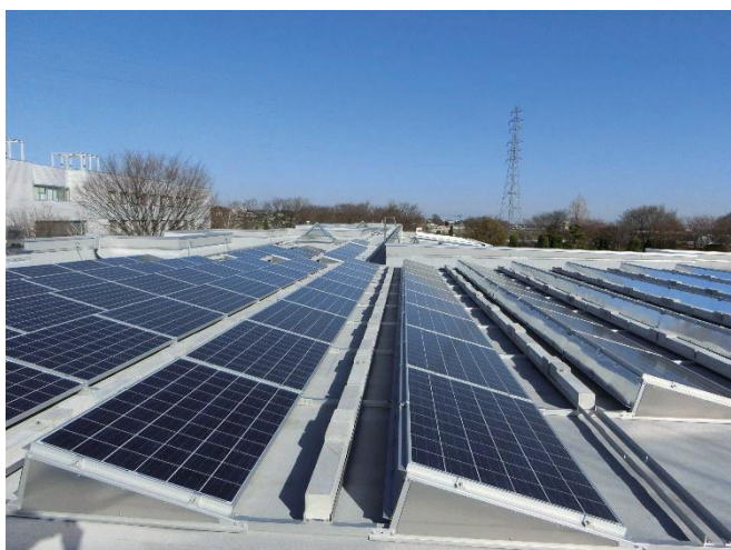
《県立県民健康科学大学の屋根に設置された太陽光パネル》
