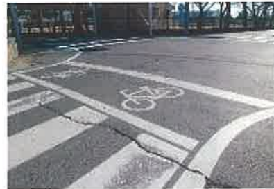
③ひび割れた道路(赤岩地内)
