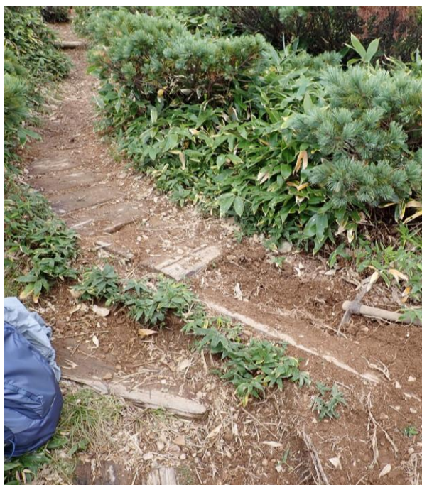
完全に埋まってしまった側溝.
