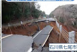
地震による道路盛土の崩落
