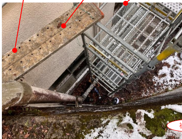
開口部措置のしていない足場
