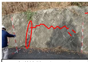
市道擁壁のクラック
