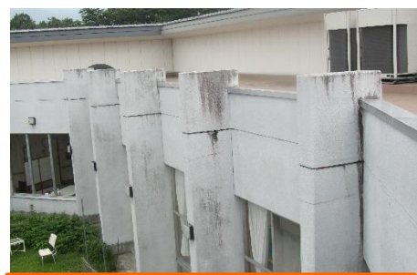
外壁のひび割れ
