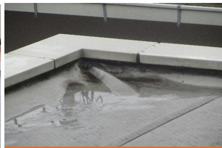
屋上防水の劣化
