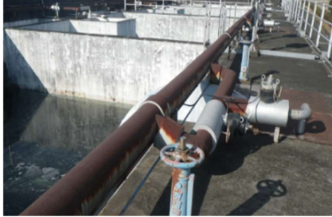
〔老朽化した1系2系浄水処理施設〕
