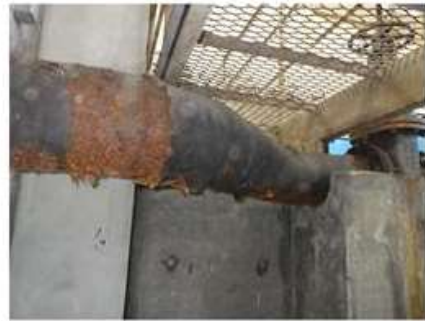
〔老朽化した送水ポンプ室内配管〕
