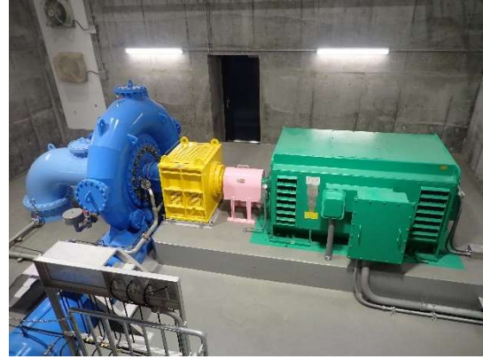
〔霧積発電所 水車発電機〕
