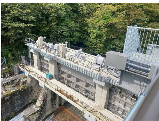
〔四万発電所 取水口（更新後）〕
