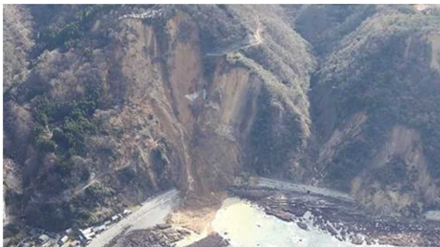
写真 国道249号の斜面崩落（能登半島地震）
