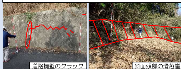
地すべり活動による変状を確認
