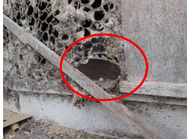
金網や防鳥ネット等の破損
