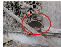
金網や防鳥ネット等の破損
