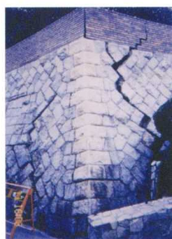
④ 擁壁隅部の亀裂
