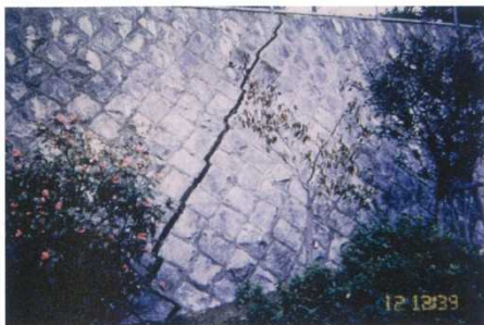
② 練積造擁壁の亀裂
