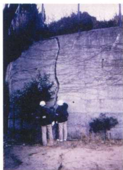
③ コンクリート系擁壁の亀裂
