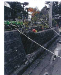
⑧ ブロック塀の転倒
