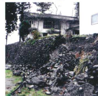
⑦ 玉石積擁壁の崩壊
