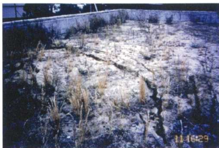
① 宅地地盤の亀裂
