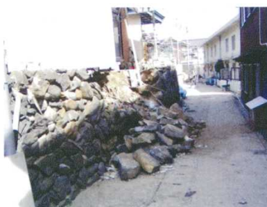
⑥ 上部に建物がある擁壁の破壊
