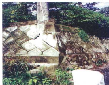
⑤ 電柱が立っている擁壁の崩壊
