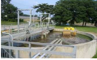
浄化処理施設
