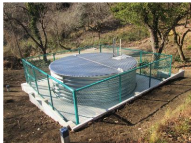
R5実施箇所の集水井
