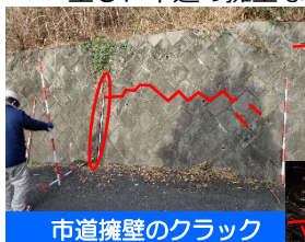
市道擁壁のクラック
