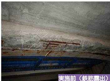
実施前（鉄筋露出）
