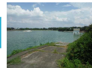
3 波志江下沼 【劣化状況調査】
