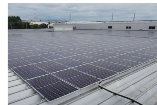
本社屋上の太陽光パネル
