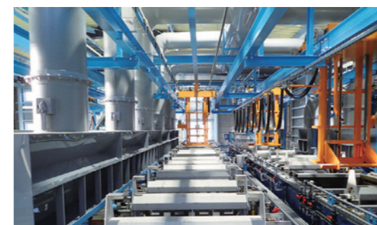
ライン設備のスクラバーダクト
