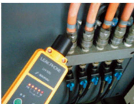
図-1 ゴムホースをバンド締めしたエア漏れ箇所
