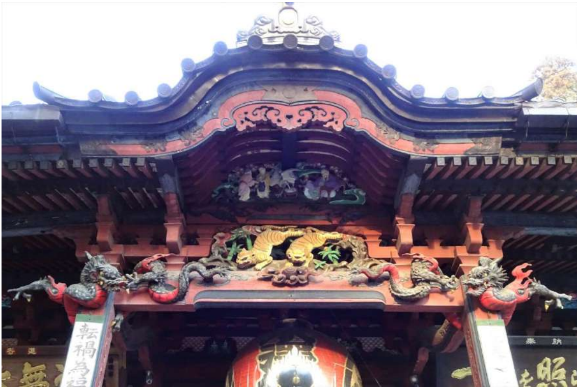
観音堂 向拝（東から） 下部彫刻「虎と竹」、上部彫刻「林和靖 りんわせい 」
