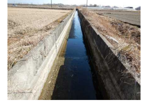
神流川用水地区 【既設水路の沈下状況】
