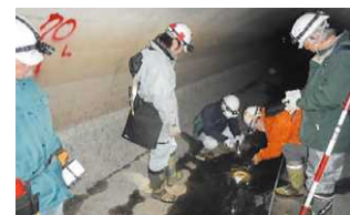
陥没原因の調査
