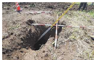
突発的に陥没した農地
