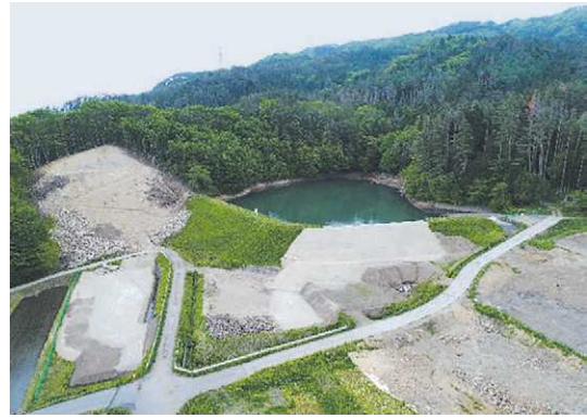
豪雨・地震対策工事实施中の防災重点ため池 （みなかみ町：池田ため池）
