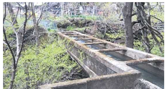
老朽化が進む農業水利施設（中之条町・美野原用水）
