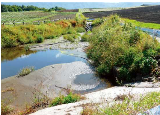
沈砂池の堆積状況（孺恋村）
