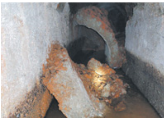
経年劣化により陥没した隧道（富岡市：甘楽多野用水）
