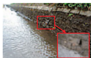
ブロックの損傷状況
