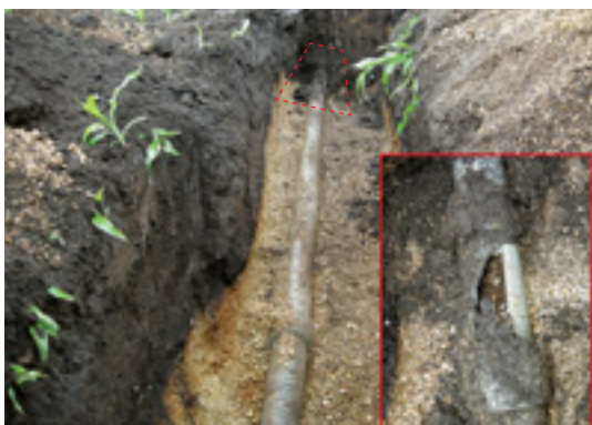
石綿セメント管の破損状況（昭和村・赤城原地区）
