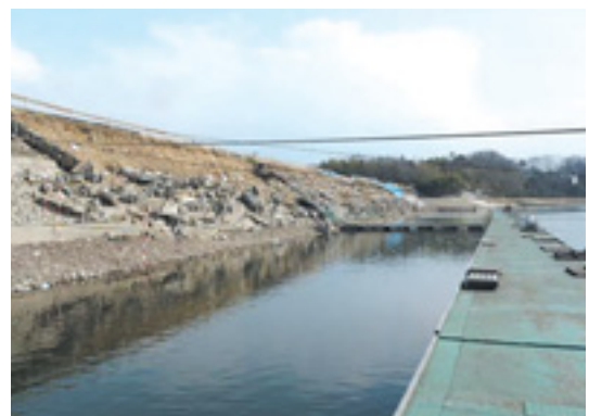
地震により被災した防災重点ため池（藤岡市：大谷池）
