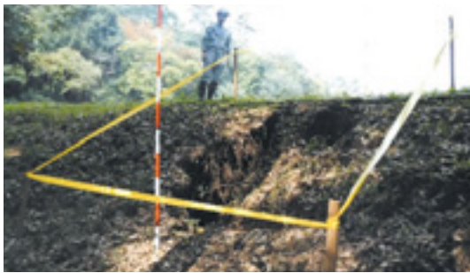
豪雨により被災した防災重点ため池 （桐生市：奥沢下沼）
