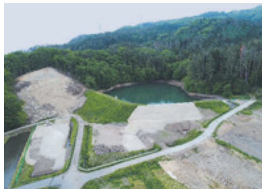
豪雨・地震対策工事实施中の防災重点ため池 （みなかみ町：池田ため池）
