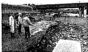
濁流で護岸が崩落した鍋川＝10月19日、富岡市田篠
