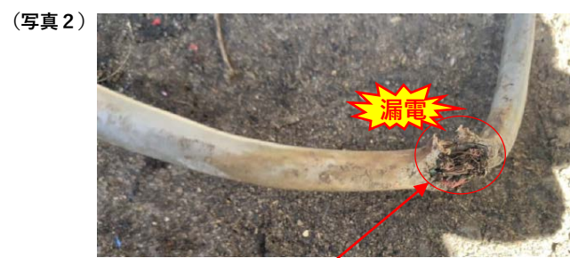
(写真2) 損傷していたキャブタイヤケーブル
