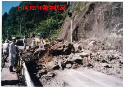
国道353号の崩落事故発生状況
