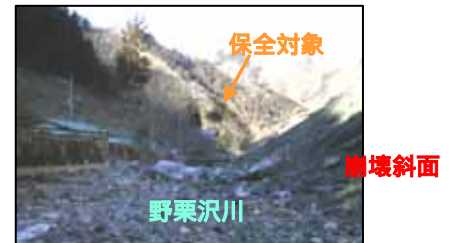
崩壊下部及び 保全対象状況
