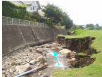
出水後被災状況
