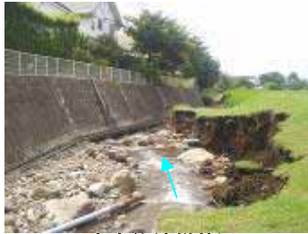
出水後被災状況
