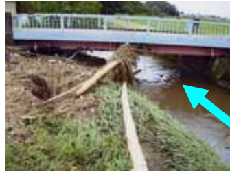
坂下橋(流木の状況)
