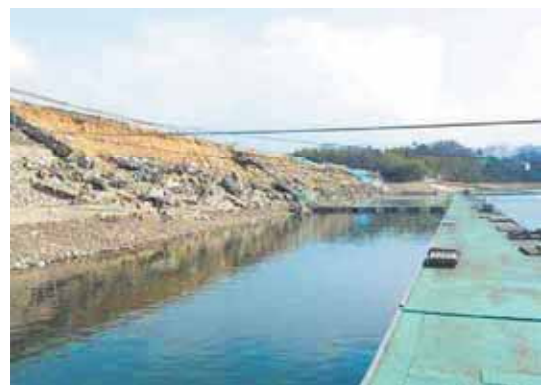
被災状況(大谷池)
