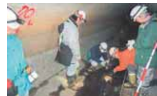
陥没原因の調査
