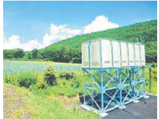
受水槽による防除用水の安定確保 (嬭恋村：干俣地区)
