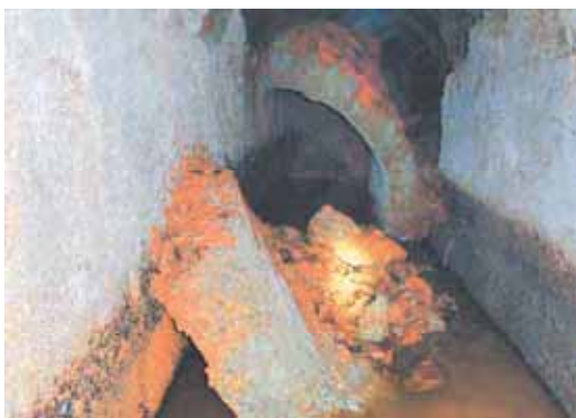
老朽化施設(甘楽多野用水)
