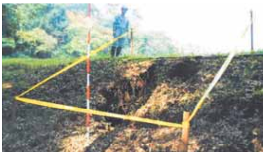
豪雨により被災したため池（桐生市）
