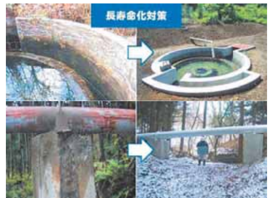
(赤城北ろく用水 監視計画に基づく施設監視の実施状況)
