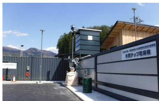
バイオマス発電所（川場村）
