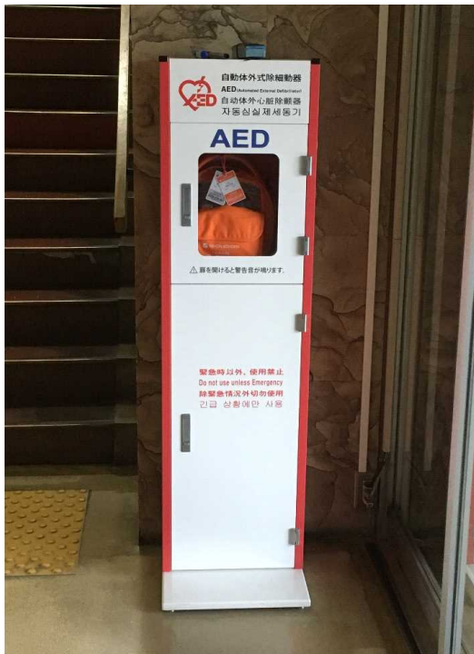
写真1 正面玄関に設置している例
