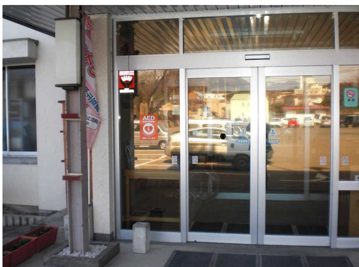
写真3 窓ガラスに設置表示板が貼付されている例
