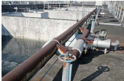
〔老朽化した1系2系浄水処理施設〕
