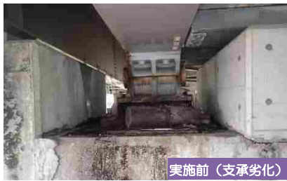
実施前（支承劣化）
