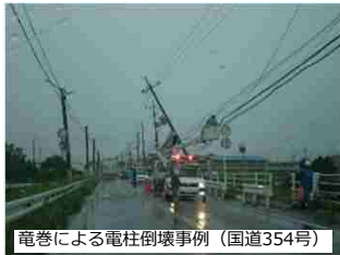
竜巻による電柱倒壊事例（国道354号）
