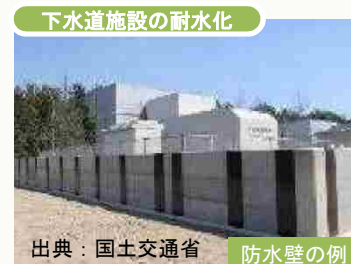
下水道施設の耐水化
