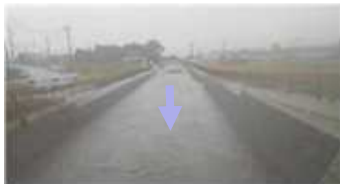
出水状況(改修済み区間)(R1.10 下田島町)
