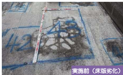
実施前（床版劣化）
