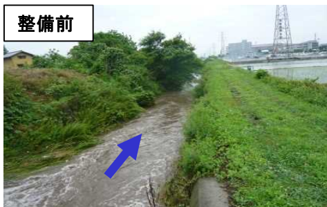
整備前 出水状況(堀の下新橋下流)
