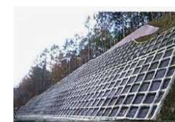
法面対策の変更
