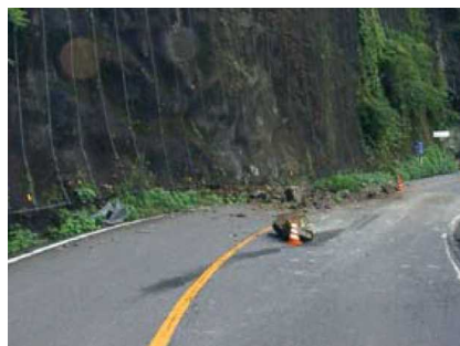
国道145号 落石(H18)
