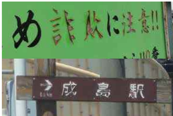
経年劣化により文字の剥がれた屋外広告物。
