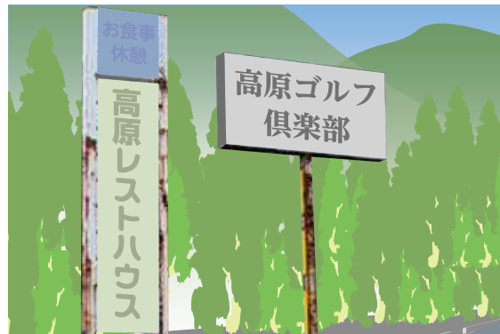
老朽化し放置された危険な屋外広告物。
