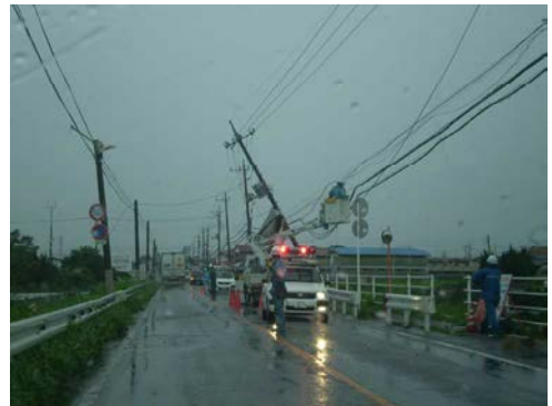
<災害時の電柱倒壊状況> (国道354号)
