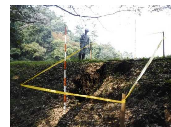
3 豪雨により被災した奥沢下沼
