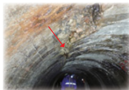
トンネル内(農業水利施設)の覆工段差状況 (沼田市：沼田平地区)
