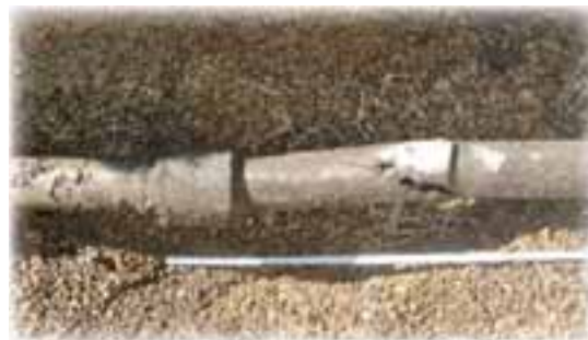
破損した石綿セメント管(昭和村：赤城北麓地区)
