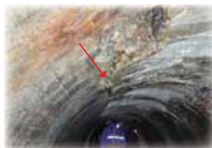
トンネル内(農業水利施設)の覆工段差状況 (沼田市：沼田平地区)
