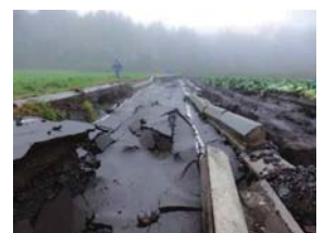
台風による農道の損壊
