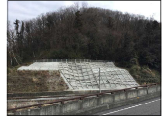
【切土による土砂災害対策】
